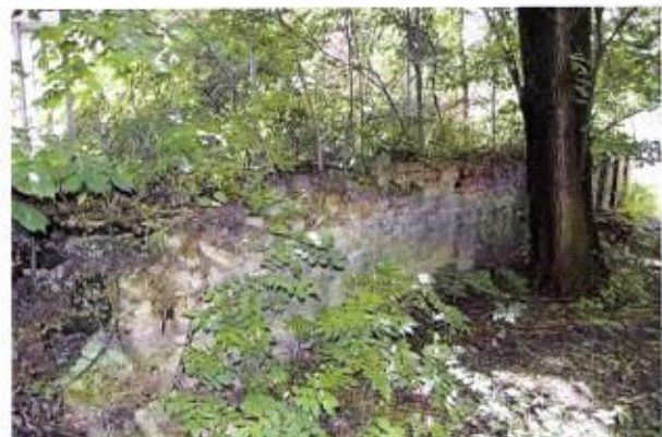
Muren mot asylgangen i nordøst, sterkt forvitret.
